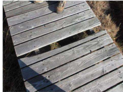
Figure 38 : Planche cassée au n° 14
