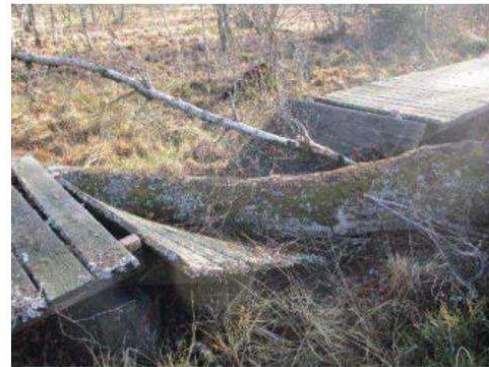
Figure 40 : Ponton cassé au n° 16
