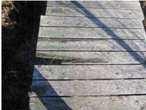
Figure 39 : Planche cassée au n° 13
